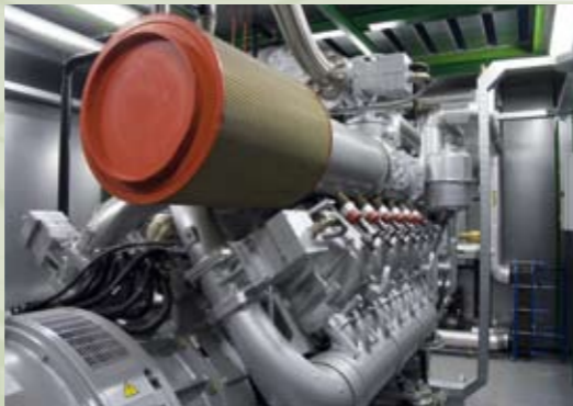
ENERG 1160 warmte/krachtinstallatie, gebaseerd op de MTU 12V 4000 L61
